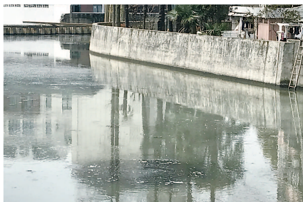
河道水质浑臭,河底淤泥翻起。
