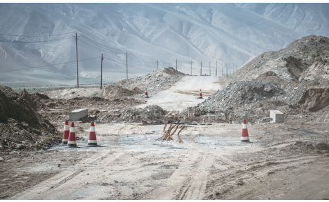
新藏线沿路塌方
