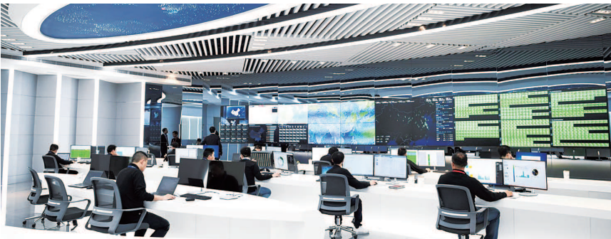
上海电气风电 IWIND 数据中心
