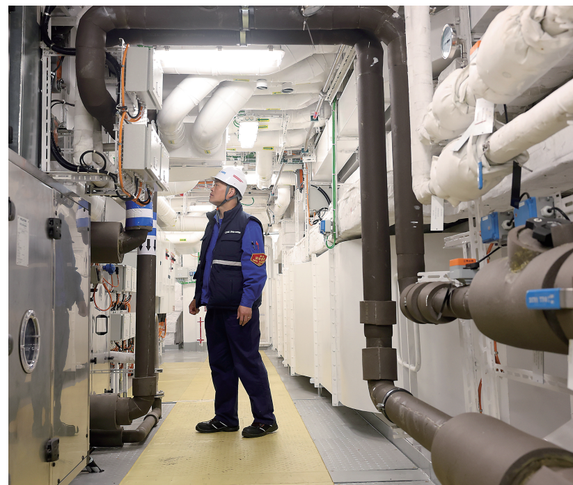
整船最复杂区域——151空调站涉及10多个系统,科幻感十足。
