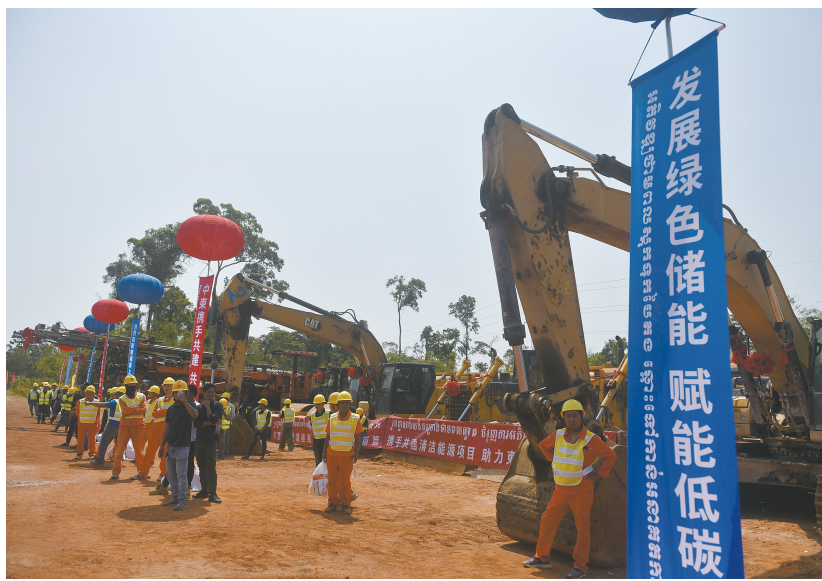
4月10日在柬埔寨戈公省拍摄的上达岱抽水蓄能电站开工仪式现场。这是中方投资的柬埔寨首座千兆级抽水蓄能电站。新华社发
